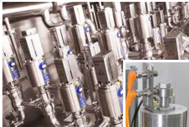
Vannes de traitement avec détecteurs de position et dispositifs supplémentaires de protection des doigts.
