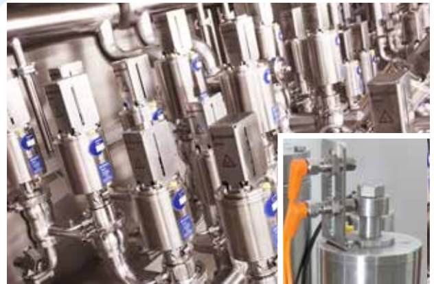
Prozessventile mit Näherungssensoren und zusätzlichen Fingerschutzvorrichtungen
